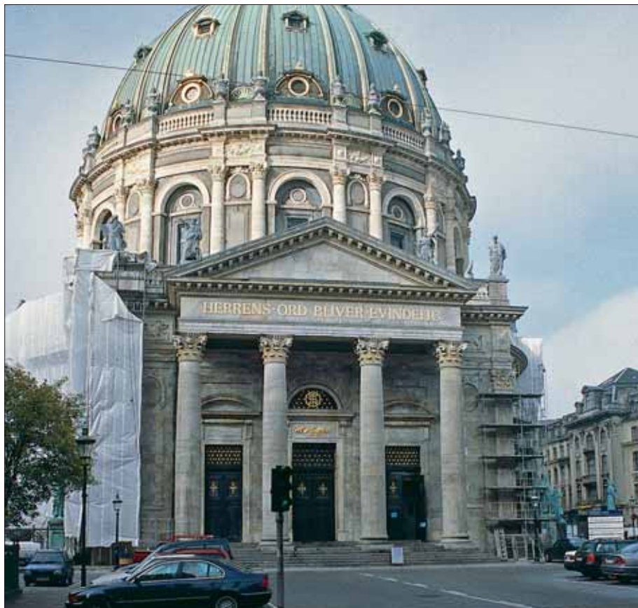
Marmorkirken i København. Gjellebekkmarmor er vakker, men litt løs og kornet. Røyk, sot og sur nedbør tæret hardt på den porøse steinen, og slik at veggene etter hvert ble svarte. I de senere år har det foregått en storstilt restaurering, og Marmorkirken fremstår i dag som en av Københavns vakre severdigheter.
